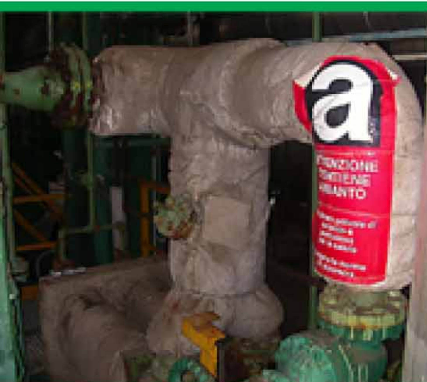
Coibentazione in amianto friabile
