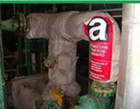
Coibentazione in amianto friabile
