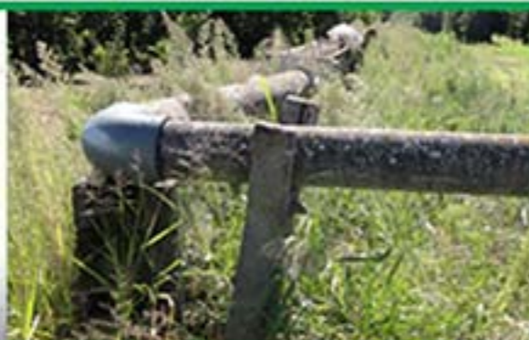
Tubazione in amianto
