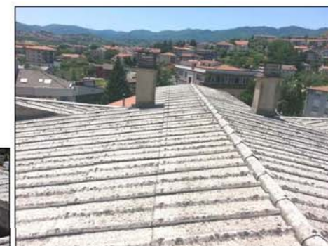
Falde principali della copertura in corrispondenza della linea linea di colmo con evidenza dello stato di degrado per l'azione congiunta degli agenti atmosferici, dell'escursione termica e degli attacchi biologici di muschi e licheni.
