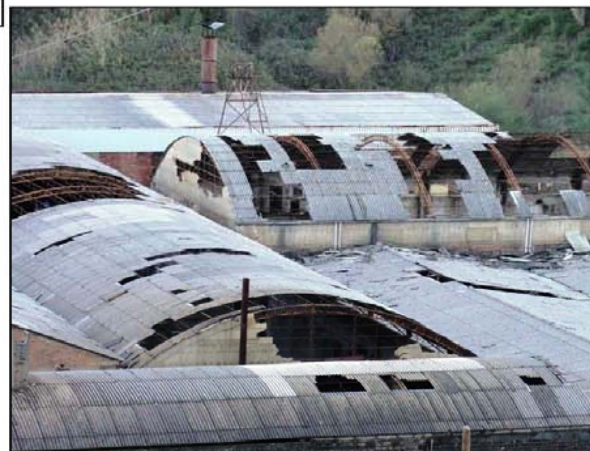
Vista particolareggiata dello stato di degrado generalizzato e molto avanzato delle lastre in cemento amianto
