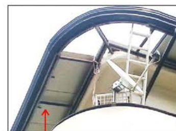
Pannelli in amianto all'intradosso dello sbalzo di copertura
