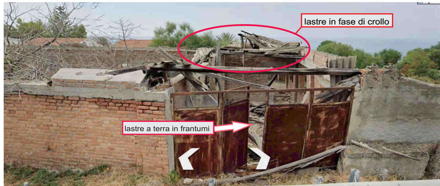
Foto N°12 - Immagine da street view (08_2022). Particolare dello stato di rovina delle strutture tale da generare il progressivo crollo delle lastre di copertura in cemento amianto disperse a terra in frantumi. Altre lastre si trovano in fase evolutiva di crollo per l'inconsistenza delle strutture portanti
