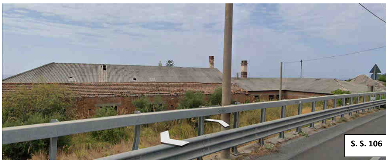
Fig. 5 – Altra immagine raffigurante il degrado delle coperture nella stessa zona di Fig. 4 (vista da direzione opposta alla precedente - Street View anno 2022)
