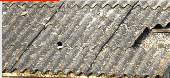
copertura in ETERNIT in avanzato stato di degrado
