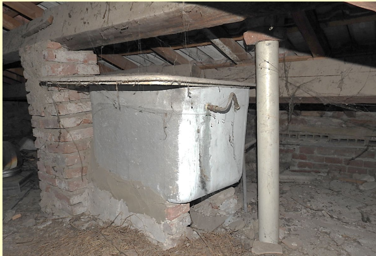
Serbatoio in un sottotetto (condizione frequente)
