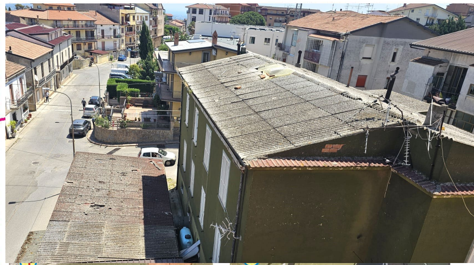
copertura in cemento-amianto in pessimo stato di conservazione
