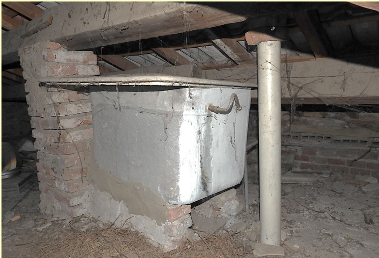
Serbatoio in un sottotetto (condizione frequente)
